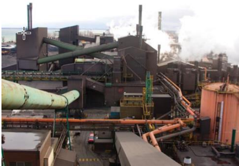
Vue d'une partie du réseau de distribution du gaz CO (tuyaux orangés)
